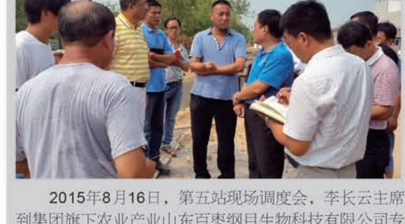
2015年8月16日，第五站现场调度会，李长云主席到集团旗下农业产业山东百枣纲目生物科技有限公司专家公寓改造施工现场，检查人工环湖，欧式阳光屋顶等项目，全员加班冲刺迎接国家级枣博会的召开。
